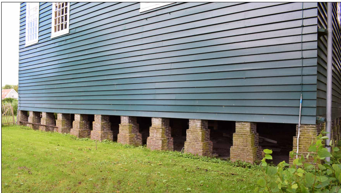
Afb. 70 De bakstenen poeren onder de houten achtergevel van de Zuidervermaning in Westzaan.
