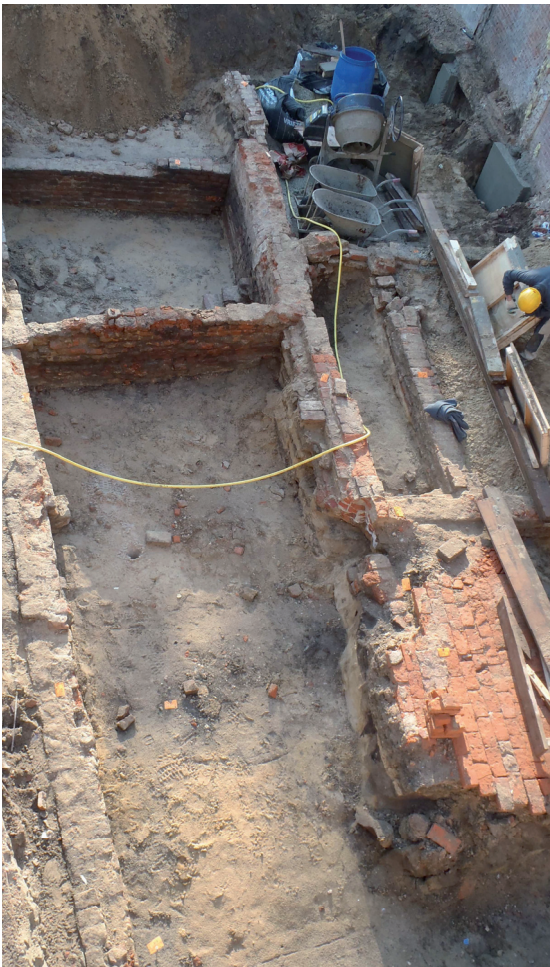
Figuur 17. Bovenaanzicht muren met linksboven kelder S20. Rechts werkzaamheden aan de stabilisatie van de buitenmuur van Meddosestraat 36.
