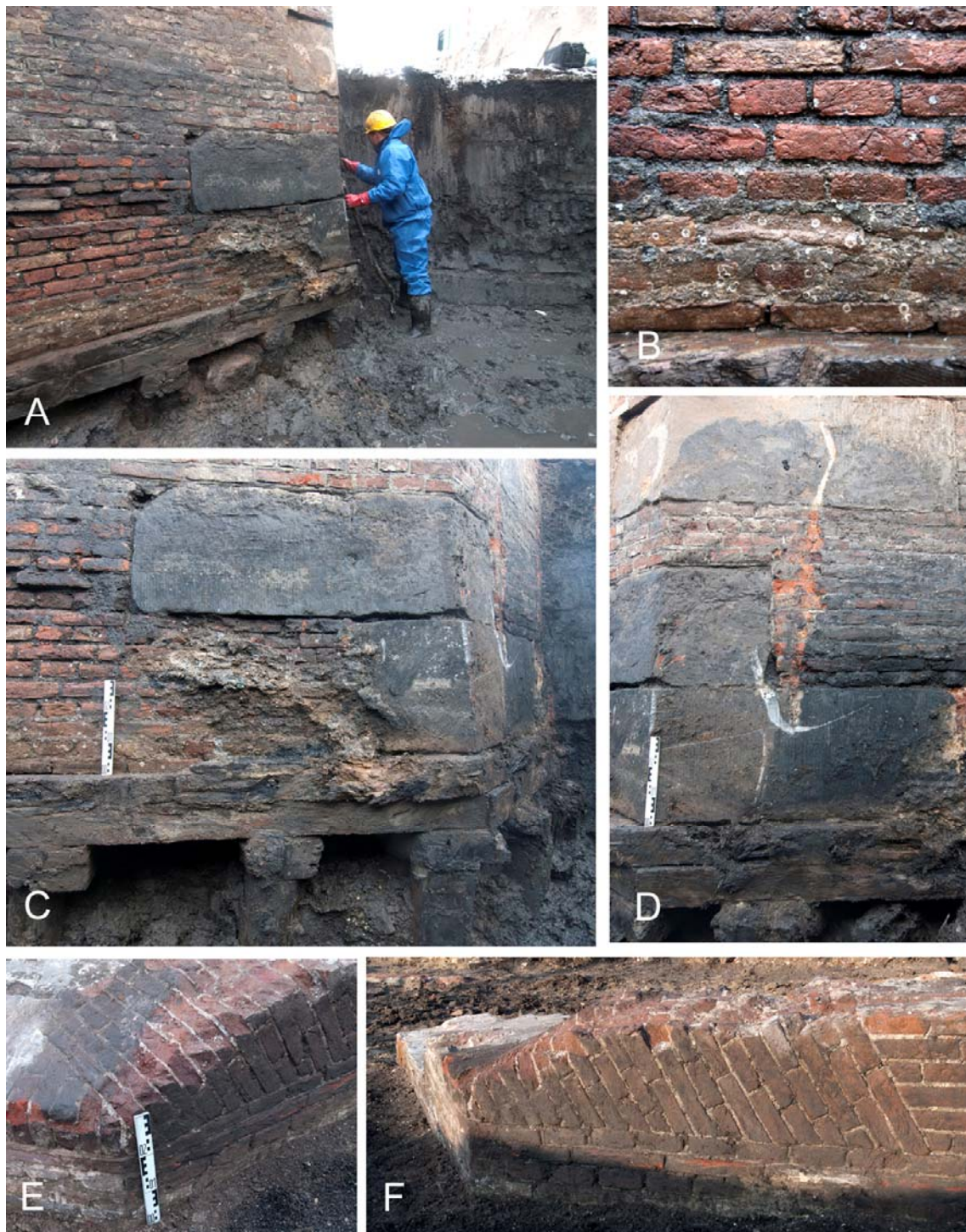
20 Details van de hoek tussen de face en de flank van bolwerk Osdorp: A) de bovenste twee planken van de beschoeiing voor de kespen en het langshout waren ter hoogte van de hoek in een eerder stadium verwijderd, B) sporen van zeepokken op de voet van de muur, C) ter hoogte van de hoek was het langshout verdubbeld, D) de hoek was uitgevoerd in natuursteen met een bakstenen band, E + F) boven- en zijaanzicht van de rollaag in klinkers op het afgetopte bolwerk
