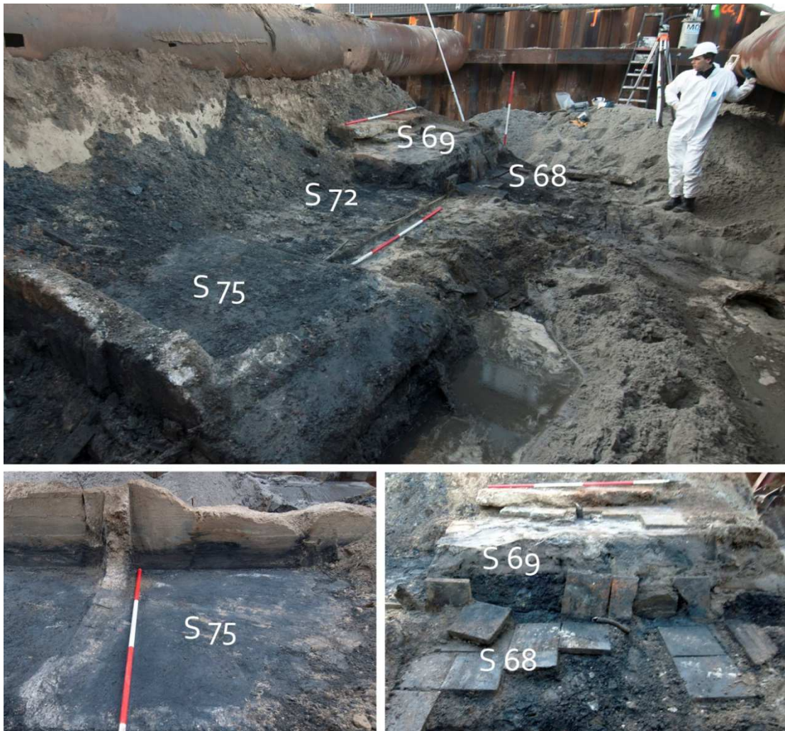
18 De vloer (S 75 en S 69) van de betonbak was gestort op een bestrating van stoeptegels (S 68), lokaal waren de tegels op een laag pek of teer (S 72) gelegd
