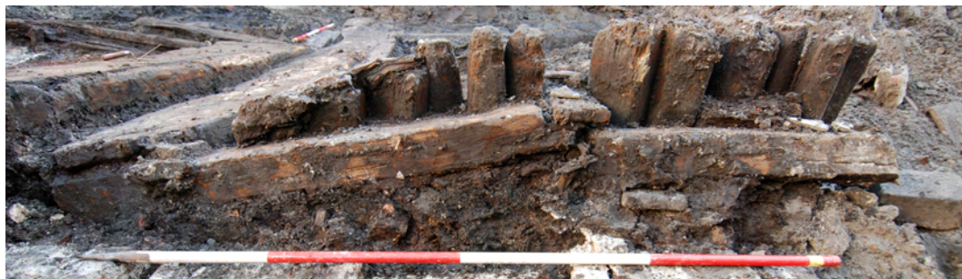
20 Het westelijke deel van de roosterfundering (S 29) onder de achtergevel van Oudezijds Armsteeg 14, gezien naar het noorden. Het houten raamwerk is hier over de palen heen gezakt
