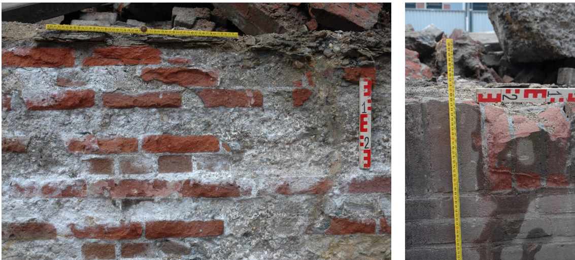
13 a (links). Gemetselde kern van de kademuur volgens een staand verband; b (rechts). afwerking van de klamp met verticaal staande baksteen aan de bovenzijde
