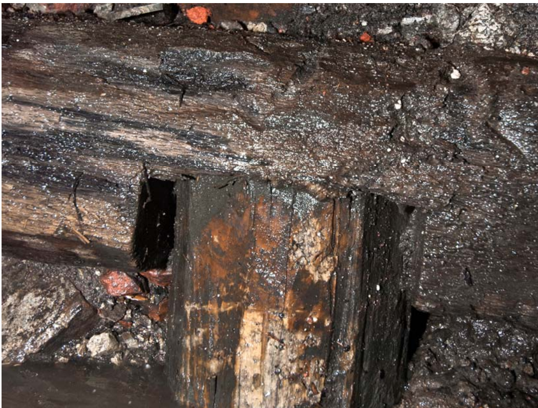
11 Detail van de raamwerkconstructie waarbij te zien is hoe de koppen van de funderingspalen met een inkeping in de onderzijde van de balken zijn ingelaten
