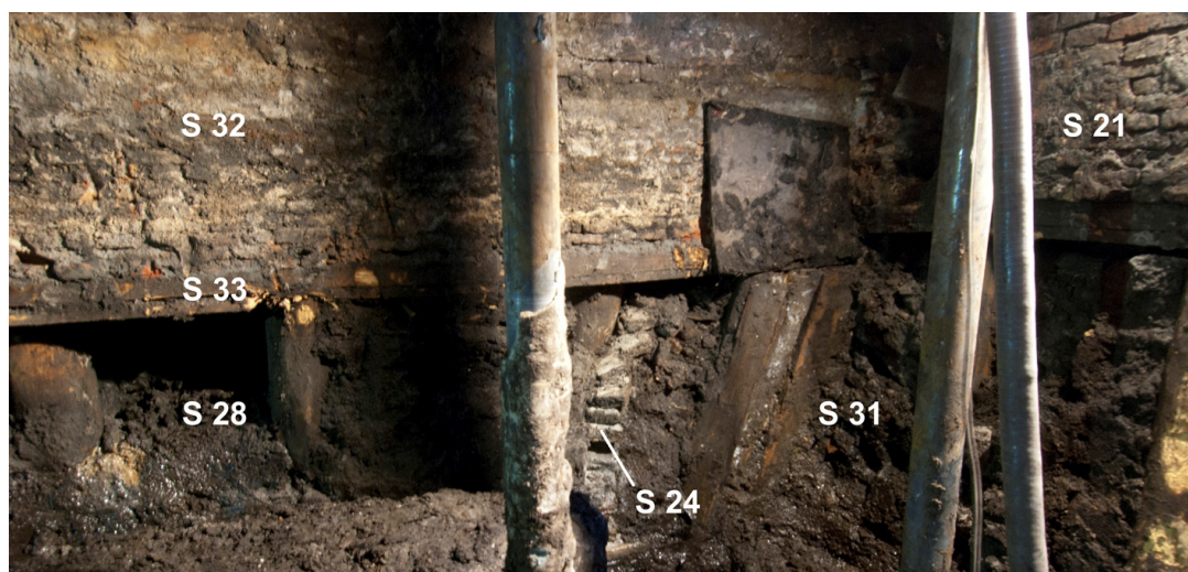
11 Na het verwijderen van de indelingsmuur S 18 kwam de tussenmuur S 32 tussen Spuistraat 3A en 3B in beeld. Het langshout S 33 rust op de mantel van beerput S 24 die is ingegraven in de ophoging S 28 en doorloopt richting het buurpand 3B. Het langshout van de voorgevel S 21 ligt op het langshout van de zijgevel
