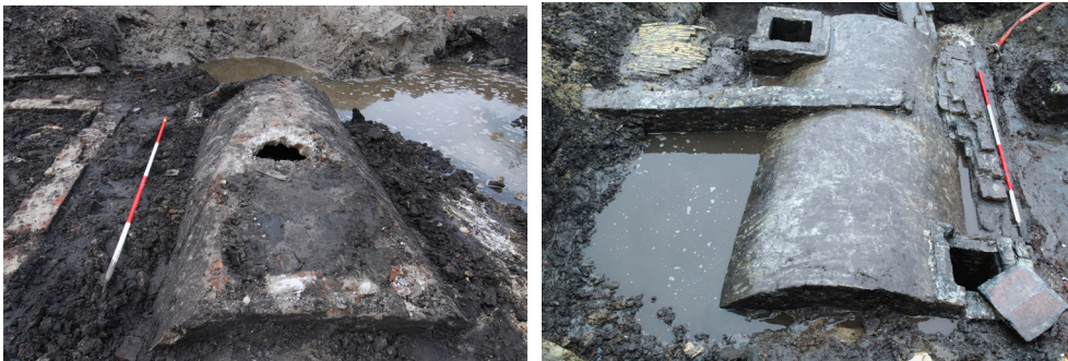
6 De beschadigde koepel van waterkelder S 4 (links) vergeleken met die van de Tweede Kostverloren kade
