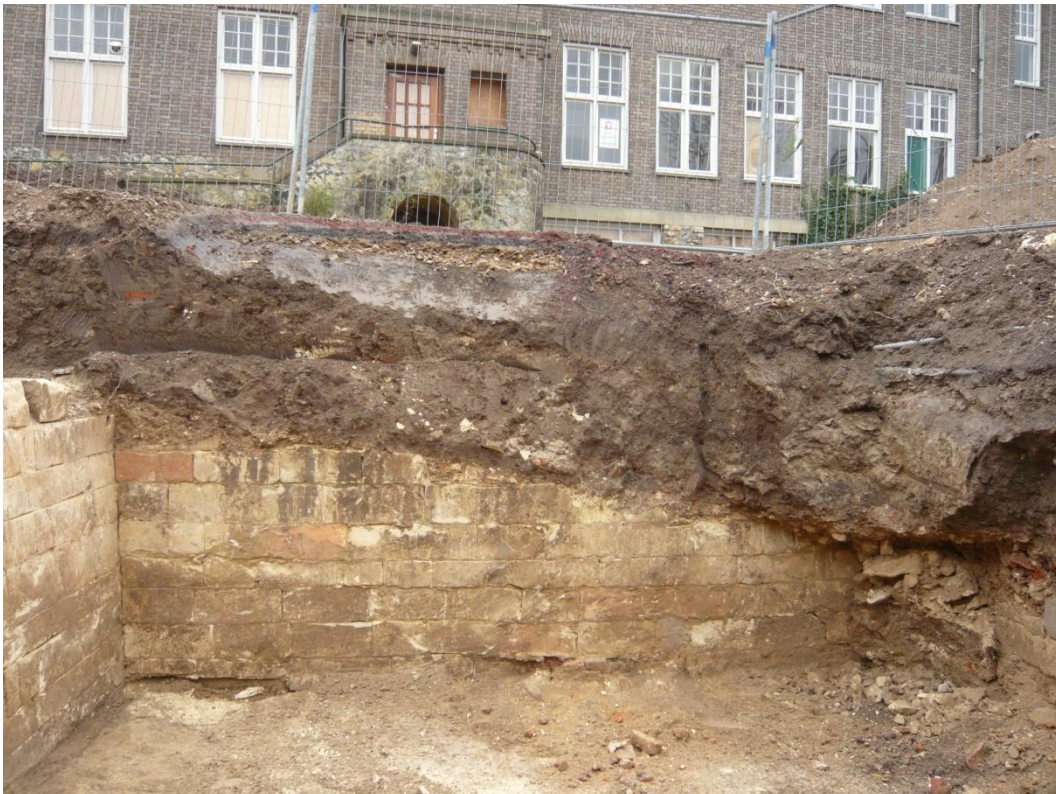
Afb. 15. Overzicht van de zuidwand (spoor 16). Ook hier is zichtbaar aan de hand van de rood verkleurde mergelblokken dat bij de bouw gebruik is gemaakt van mergelsteen dat afkomstig is een door brand verwoest gebouw.
