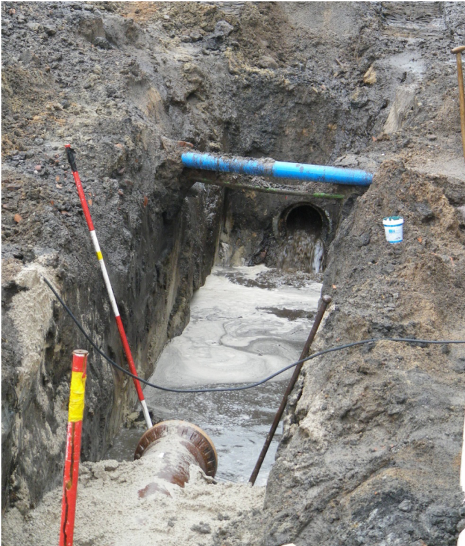
Afb. 3. Tijdens een heftige regenbui stroomt het oude riool leeg in de werkput (put 2).
