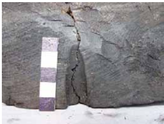
Fig. 18.39 Een lepelboorgat aan de onderkant van spant 23.
