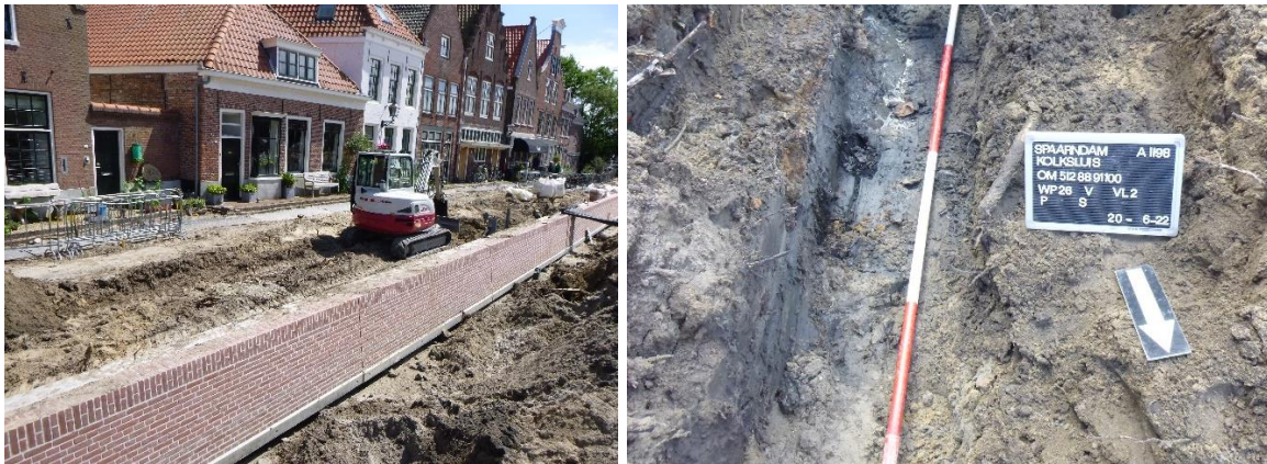
Figuur 6: Links een sferimpressie van de werkzaamheden tijdens het ontgraven van de drain (foto richting zuiden). Rechts een voorbeeld van het vlak op de maximale ontgravingsdiepte t.b.v de drain.
