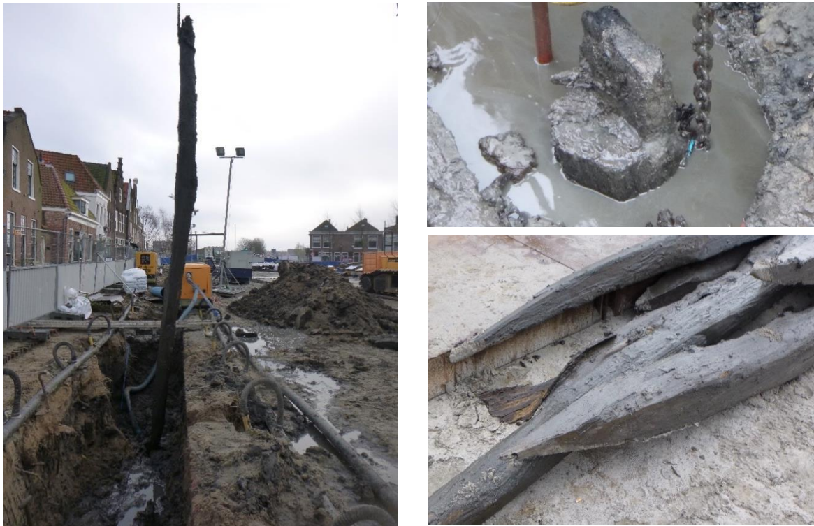
Figuur 12: De heipalen (S11) waren ca. 4 tot 7 m lang. Links is te zien dan één van de palen wordt getrokken. Rechts onder is de aanpunting van de paal weergegeven en rechtsboven is de bovenzijde van de paal afgebeeld. Door de profilering van de kop konden de palen aan het langshout worden gefixeerd.
