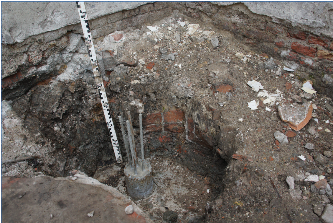
Figuur 10. Muurrestant dat waargenomen is in het boorgat van één van de heipalen. Zie figuur 6 voor de richting van de foto.
