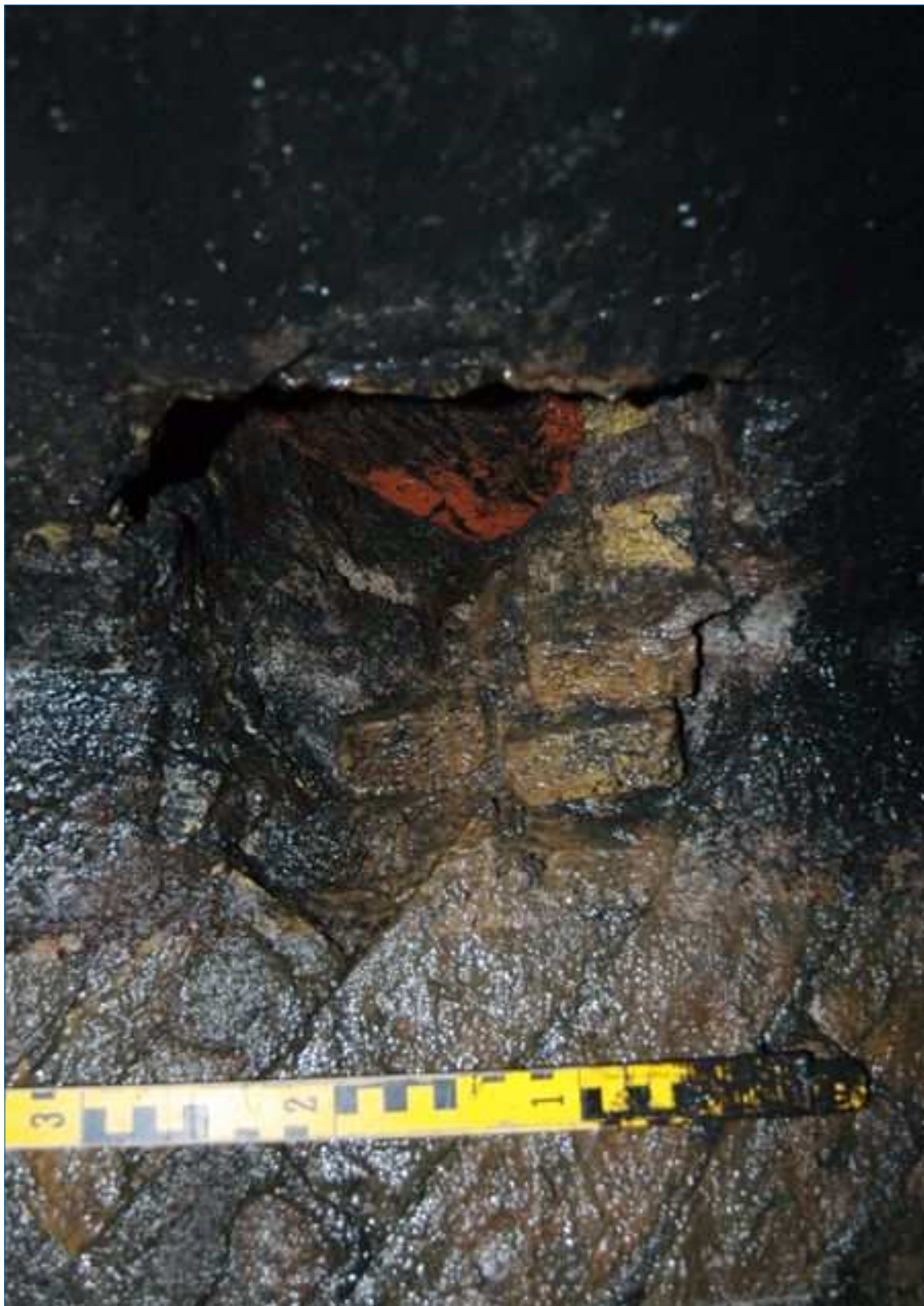
Figuur 9.14. Dichtgemetselde opening loden overloop of inlaat (S400; Vanoverbeke, 2010).
