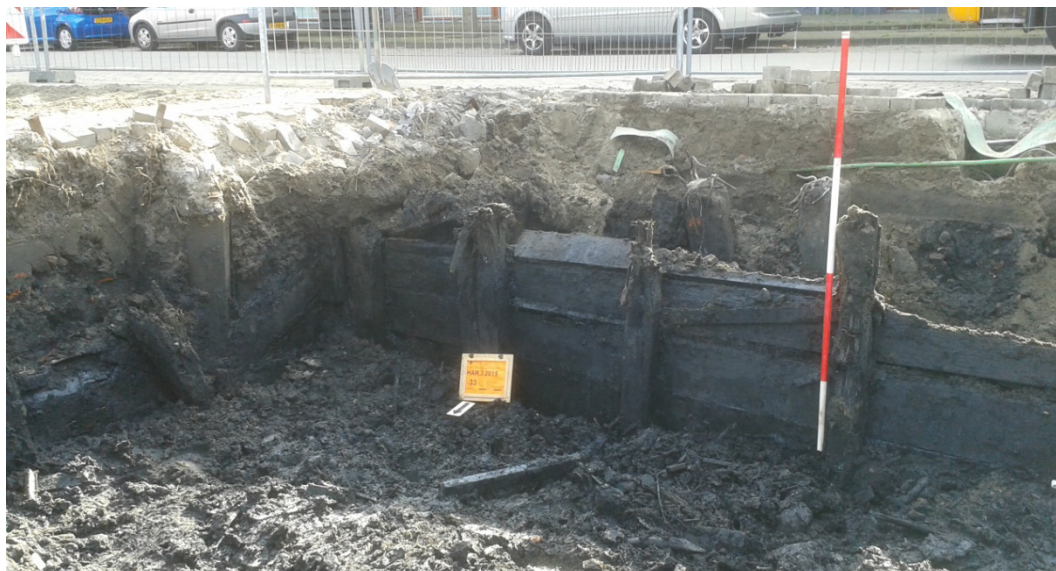
Afb. 19. De beschoeiing van de 18 e -eeuwse fase van de insteekhaven (S0004B). Foto richting zuidwesten.
